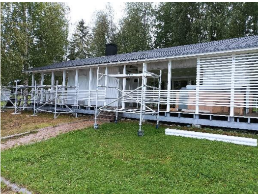
Vain rännit puuttuu. Kuva 5
