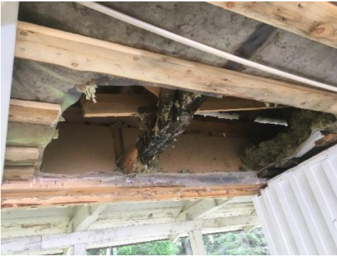
Vesivahinkoja ilmaantui. Kuva 3
